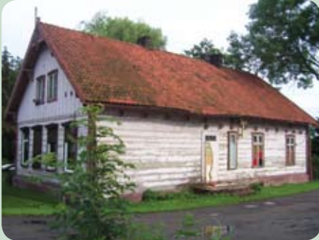
Świetlica przed remontem
