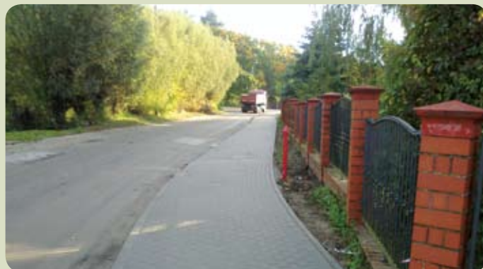
Zakończyła się budowa chodnika przy ulicy Spacerowej w Straszynie. Część jezdni wydzielono na chodnik. Przed przystąpieniem do budowy wymieniono sieć wodociągową co spowodowało właściwe utrzymanie ciśnienia wody na Osiedlu Hoffmana i ul. Dworcowej. Warunkiem przystąpienia do inwestycji było zakończenie budowy ulicy Dworcowej, ponieważ jej modernizacja pozwoliła zmienić na ul. Spacerowej ruch na jednokierunkowy.
